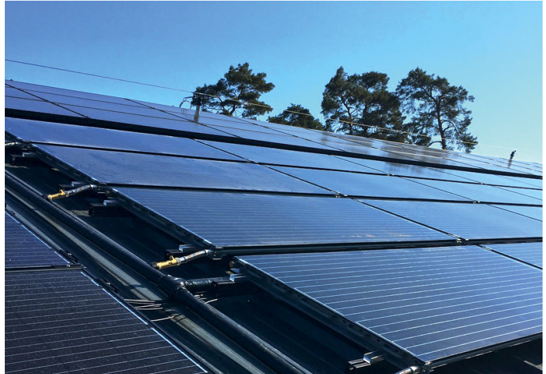
80 m 2 SOLINK installation in Lüttich (BE)
